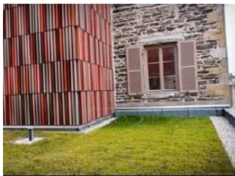
Toiture végétalisée (source : Grand Lyon)
